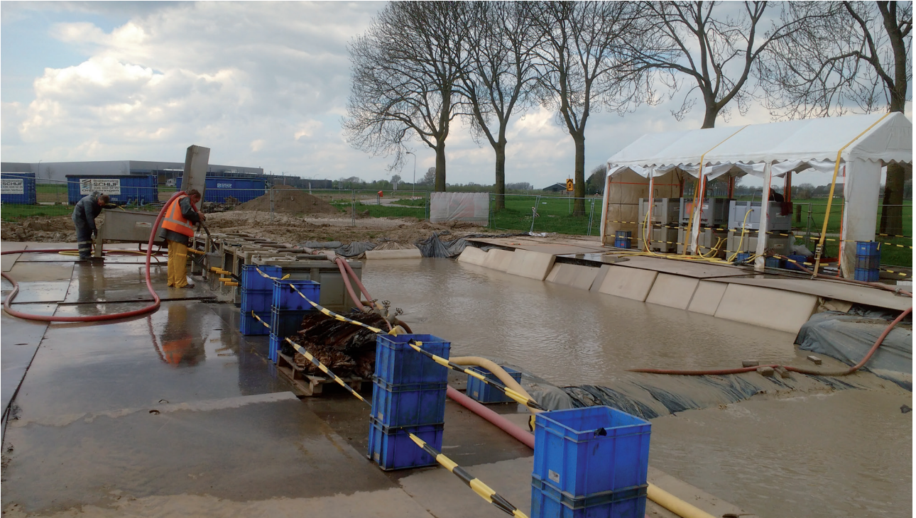
Figuur 2.7. De hondenhokken en de grote Lutterzeef (geopend) in werking. Op de achtergrond achter het slipdepot in blauwe containers de grondwaterreinigingsinstallatie. Aan de overkant van het zeefbassin de overdekte spoelinstallaties.
